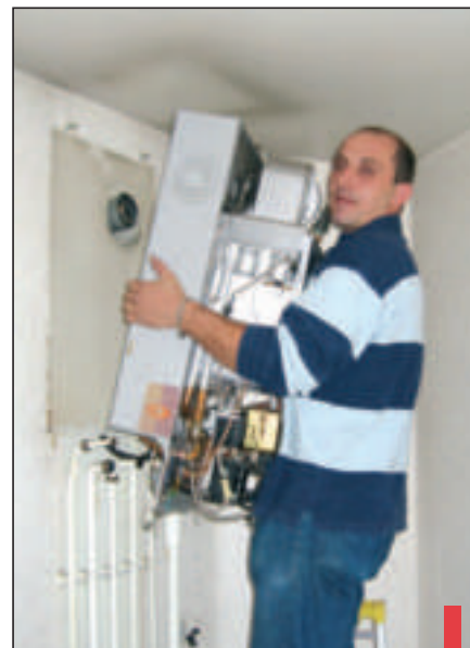
De très nombreux changements de chaudières.
