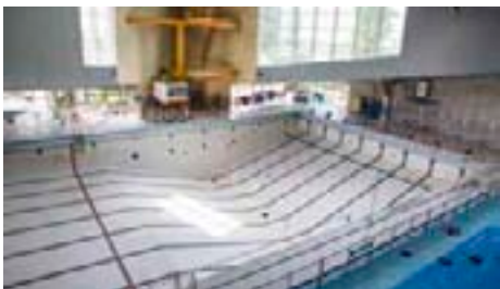
► La piscine, fermée depuis le 4 avril, suite à des fuites.
