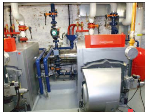
Dans les bâtiments publics, des chaufferies réglables au degré près.
