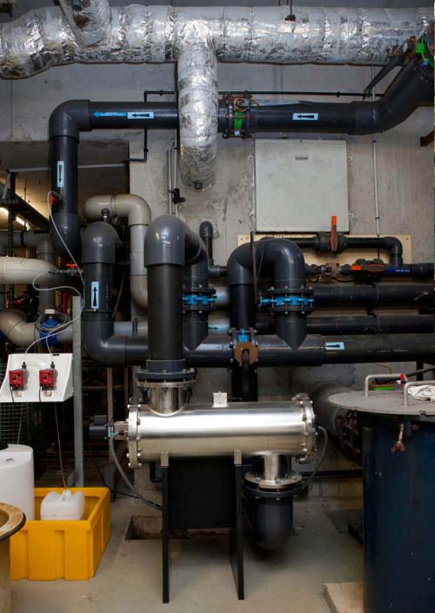
À travers ce tube, appelé déchloraminateur, l'eau est stérilisée au moyen de lampes UV.
