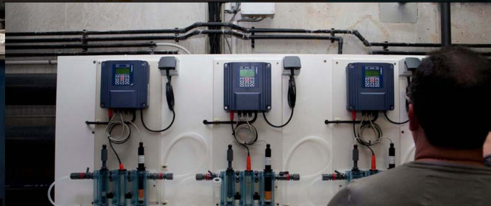
Le taux de chlore dans l'eau est contrôlable en temps réel dans les sous-sols de la piscine.
