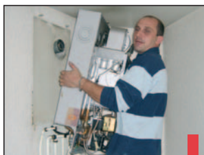
1080 chaudières ont été changées depuis 2001.
