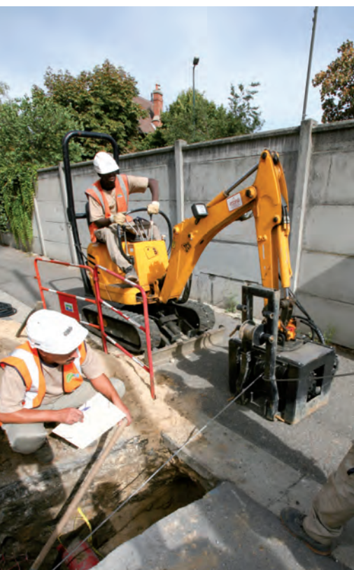
Les réseaux de distribution et d'assainissement sont régulièrement contrôlés afin d'assurer une bonne qualité de l'eau.
